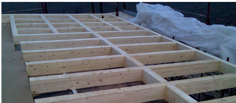
Posa in opera della struttura portante di copertura e realizzazione di isolamento a cappotto ed intercapedine ventilata
