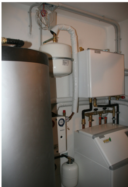
Vano impianti con serbatoio di accumulo per i collettori e pompa di calore geotermica
